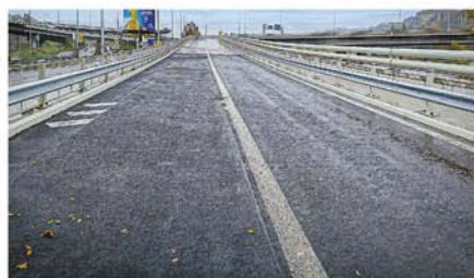
Barrandovský most – nájezd Strakonická, svodidlo ZMS4-A3/H2 vlevo s výplní tahokov, vpravo bez výplně.
