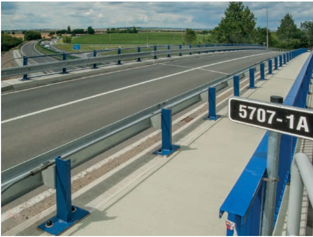
Svodidlo MS4-1/H2 na mostě 5707-1 přes D46
