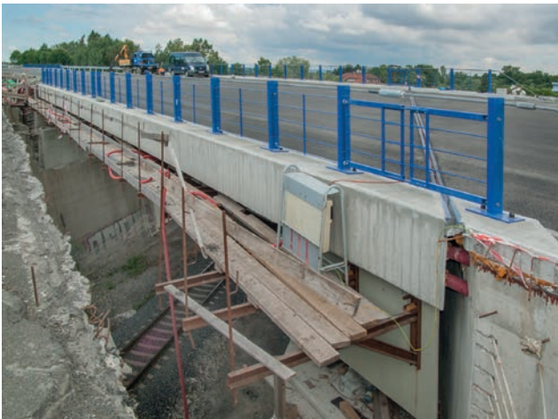
Svodidlo ZMS4-1/H2 na D48 u Příbora
